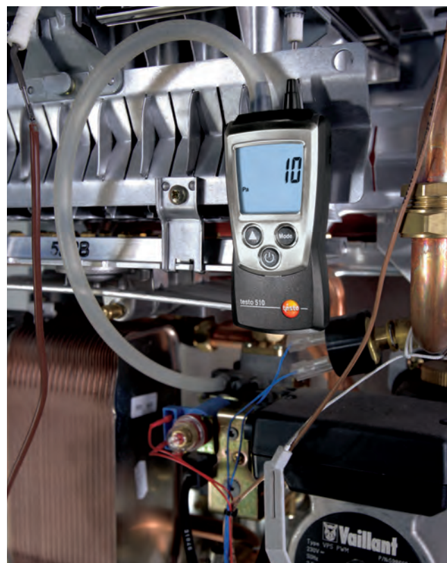
Odečítání připojovacího tlaku plynu a tlaku na tryskách na přístroji testo 510.
